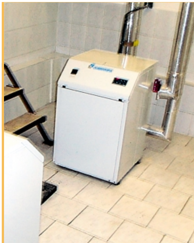
Рис. 8. Тепловые насосы системы горячего водоснабжения
