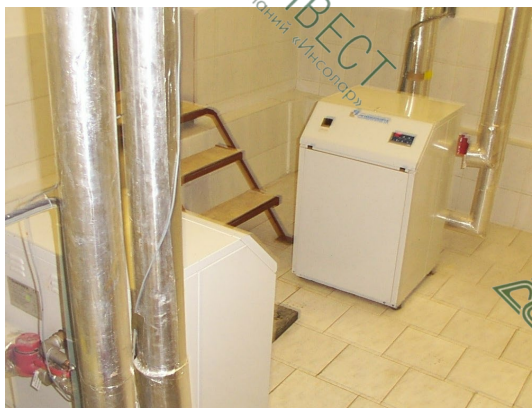
Рисунок 4. Общий вид теплонасосного оборудования
